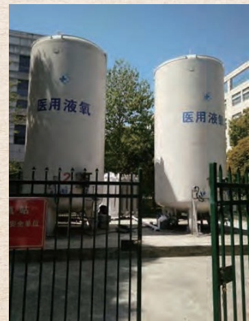
医院液氧储罐
