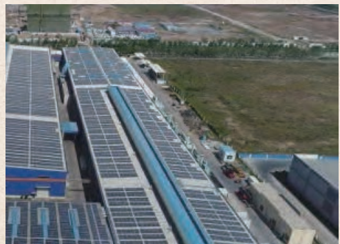
青岛冷藏箱基地光伏电站
